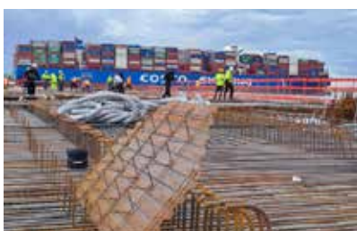
Terminal LNG w Stade nad Łabą, Niemcy
