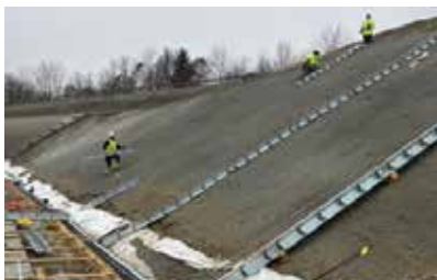
Elektrownia Töging-Jettenbach, Niemcy
