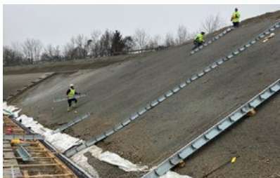
Elektrownia Töging-Jettenbach, Niemcy
